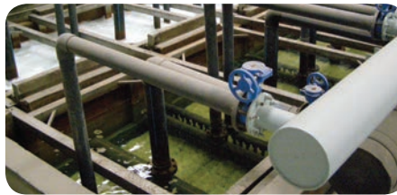
Planta de tratamiento terciario de Boatou Steel, Mongolia Interior, China
